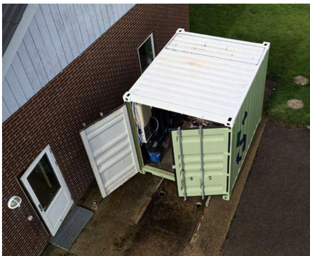
Foto: MicroChange har installeret en mobil container udenfor Harboøre renseanlæg.
